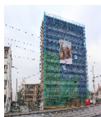
Fotonummer F 09301769 C Aufnahmejahr 2017 Fotograf Fischer, Mandy Beschreibung Bürohaus und Nebengebäude (Verwaltungstrakt) - Ansicht von S
