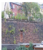
Fotonummer F 08957661 B Aufnahmejahr 2013 Fotograf Hoppe, Hans Dirk Beschreibung Stützmauer an der Bahnlinie
